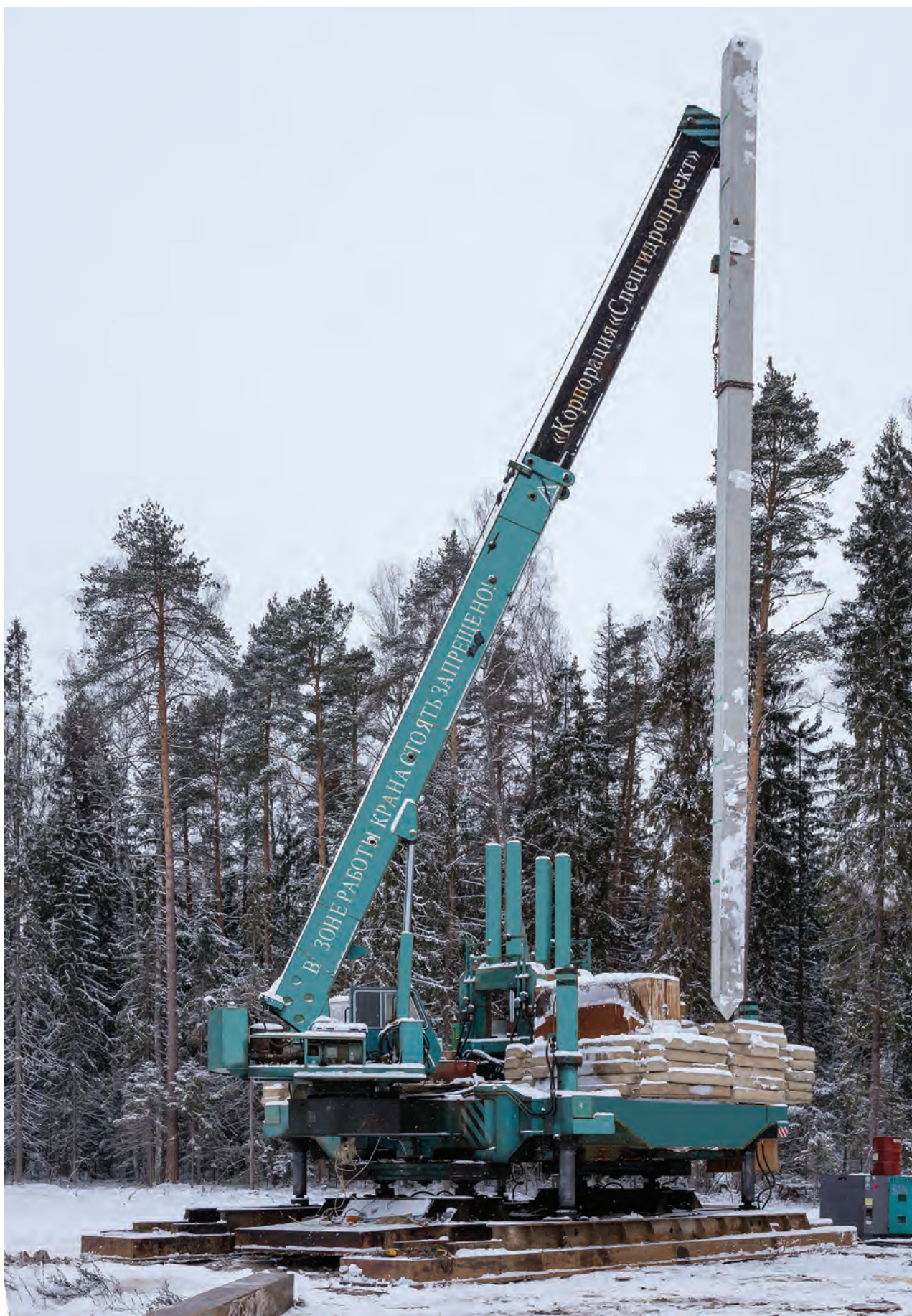
Лаборатория физики высоких энергий им. В. И. Векслера и А. М. Балдина, декабрь. Площадка будущего комплекса NICA. Работает машина по вдавлванию свай
